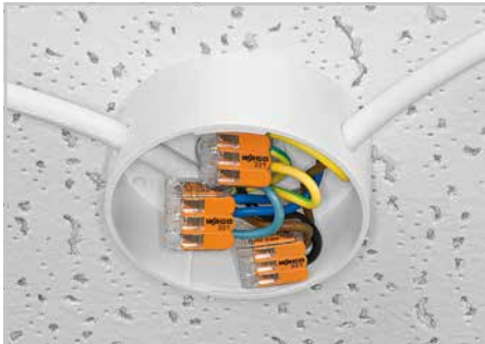
Leuchtenverteilung in Deckenbaldachin
