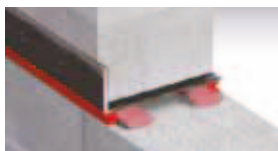
Spáry mezi stěnou a kovovým profilem
