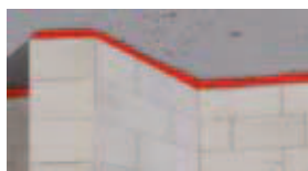
Spáry mezi stěnou a stropem
