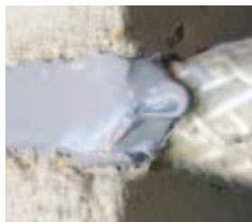
Spáry v podlahových a stropních konstrukcích
